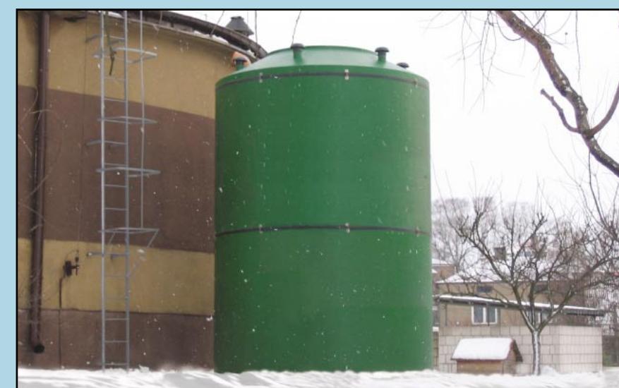
Instalacja do oczyszczania powietrza BW-2000 przy przepompowni ścieków w Suwałkach
